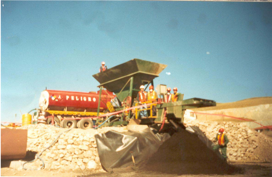
Fig 3.10.- Planta de Producción de Mezcla Con emulsión Asfáltica en Obra
