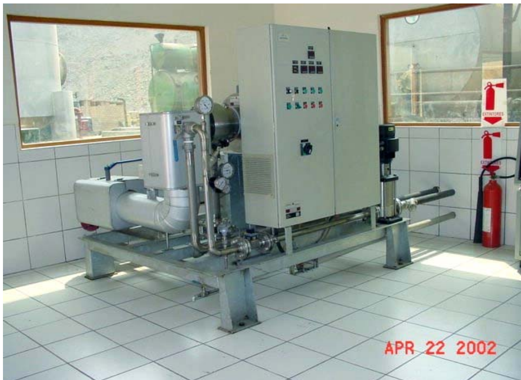
Fig 3.8.- Planta de Producción de Emulsión Asfáltica
